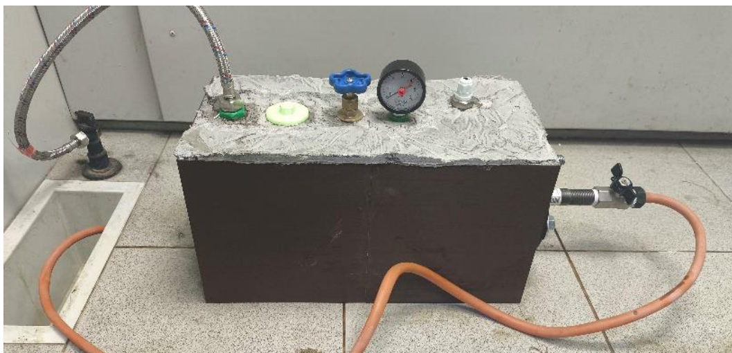
Рис. 3. Узел трубопроводной обвязки, изготовленный по технологии НАО.
